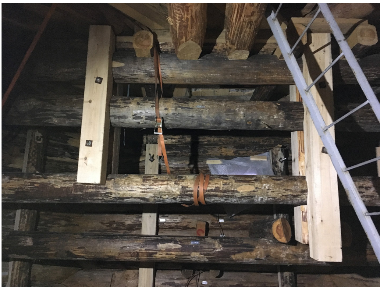
Рис. 10. Сжимы на внутренних конструкциях
